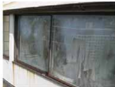
façade sud, 9e, travées 8/9
