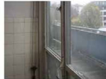
façade sud, 8e, travées 15/15
