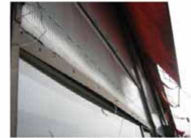
façade sud, 6e, travées 14/15
